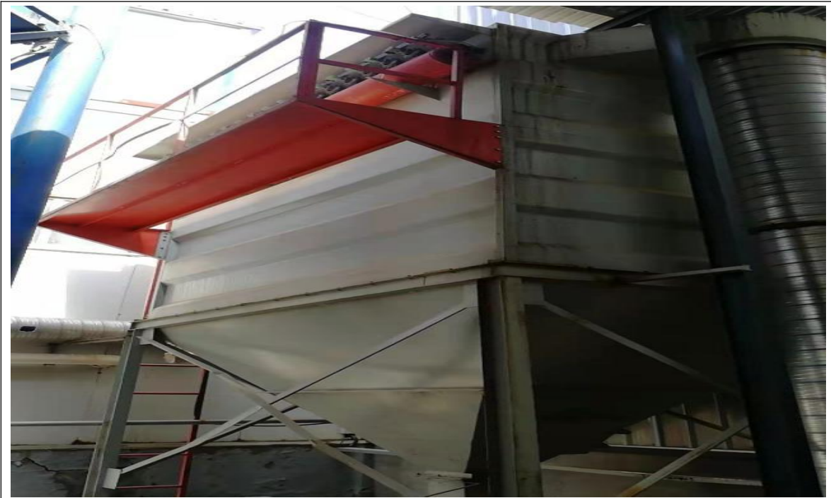
特种砂浆生产线投料、物料运输、搅拌、包装工序脉冲布袋除尘器及排气筒
