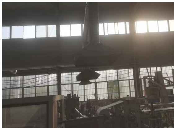
涉及 VOCs、氯乙烯、HCl 废气得 集气罩和收集管线
