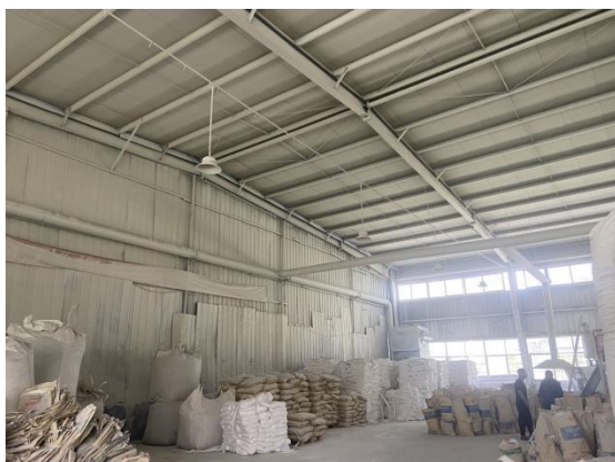
涉及粉尘工序得废气收集管线
