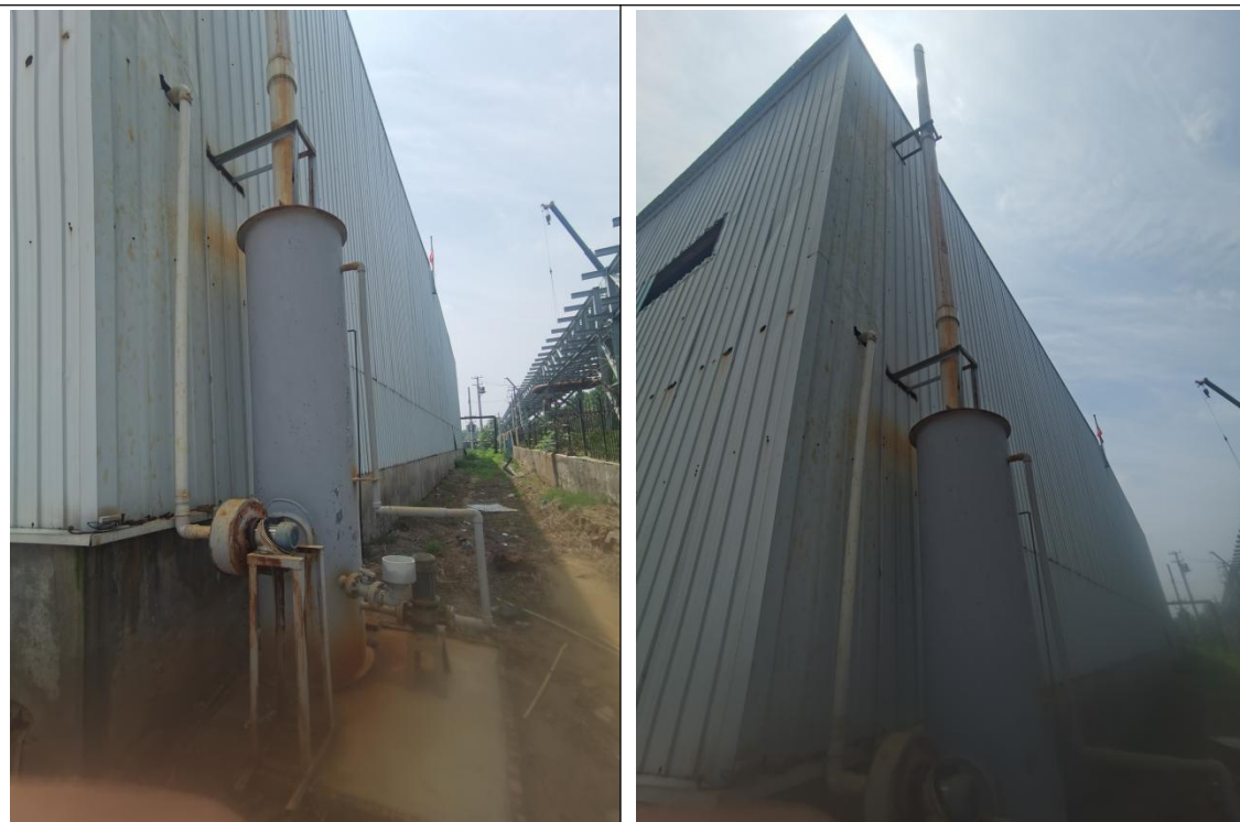
水喷淋+25m 排气筒（P2）
