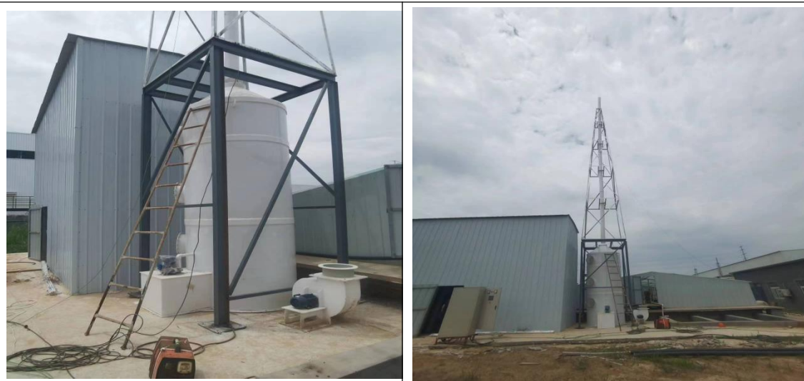
除臭喷淋+15m 排气筒（P3）
